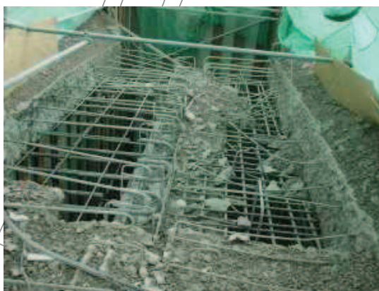
Σχήμα 1. Αποσύνθεση πλάκας οπλισμένου σκυροδέματος με υδροκοπή (hydrodemolition) με ταυτόχρονη αποκάλυψη του οπλισμού
