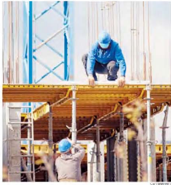
Θεσιάζεται ο επαναληπτικός έλεγχος ανά πέντε έτη από διαφορετικούς κάθε φορά ελεγκτές δόμησης για κτίρια που έχουν κάνει χρήση των κινήτρων του ΝΟΚ.
